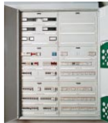
裝有常規設備和EIB設備的控制櫃
